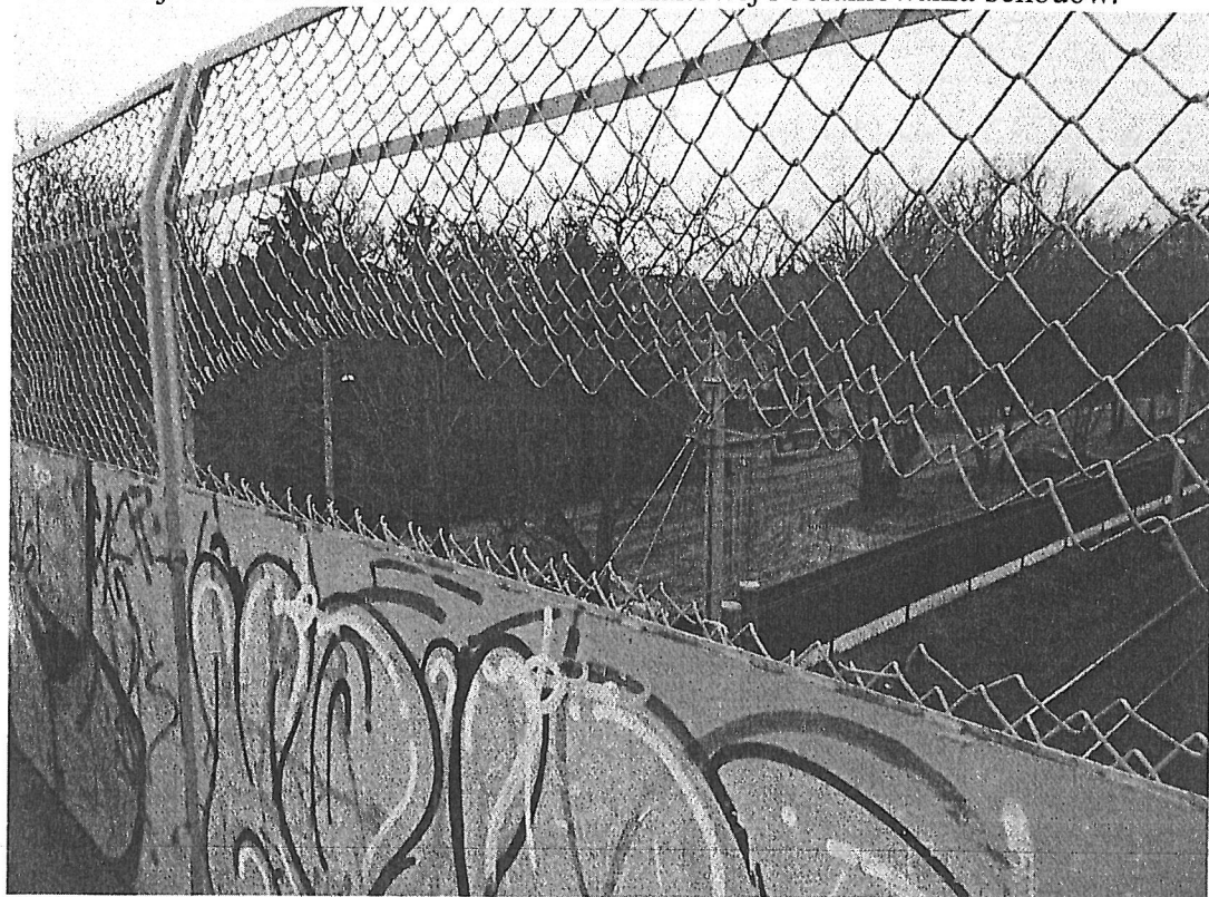
Fot. 3 Uszkodzenie siatki osłony przeciwporażeniowej.
