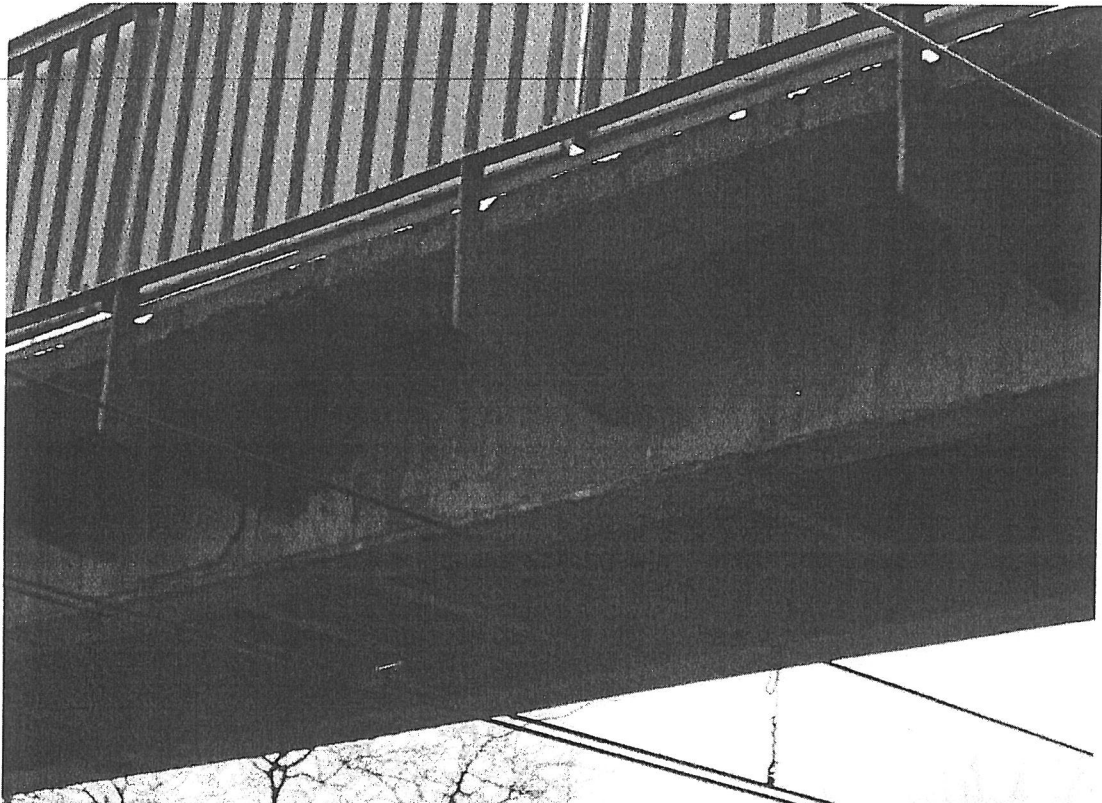
Fot. 4 Uszkodzenia powłok antykorozyjnych, korozja elementów stalowych oraz ubytki w elementach prefabrykowanych pomostu.
