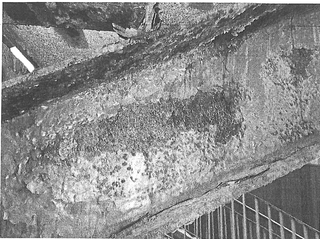
Fot. 6 Całkowicie zniszczona powłoka antykorozyjna z zaawansowanym procesem korozyjnym konstrukcji stalowej schodów.
