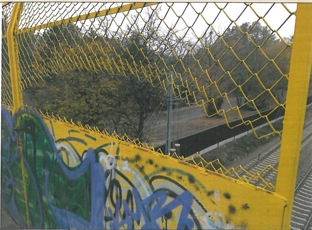
24. Uszkodzone zabezpieczenie balustrady - siatka
