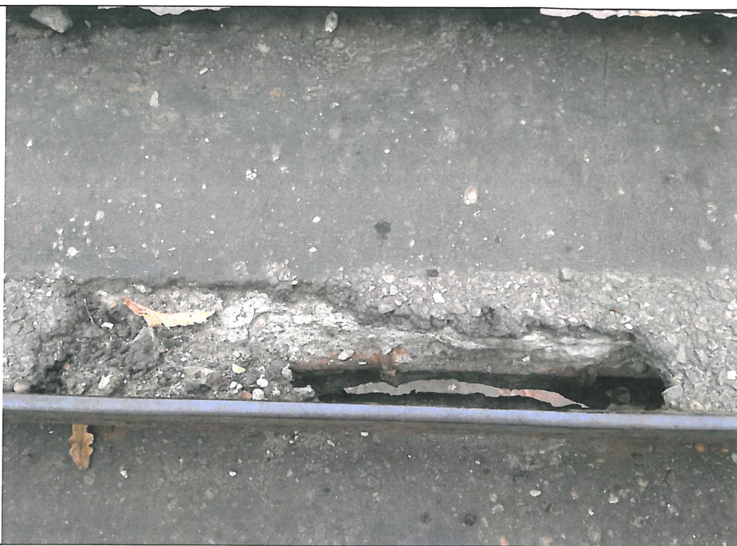
17. Ubytki betonu i asfaltu Korozja elementów
