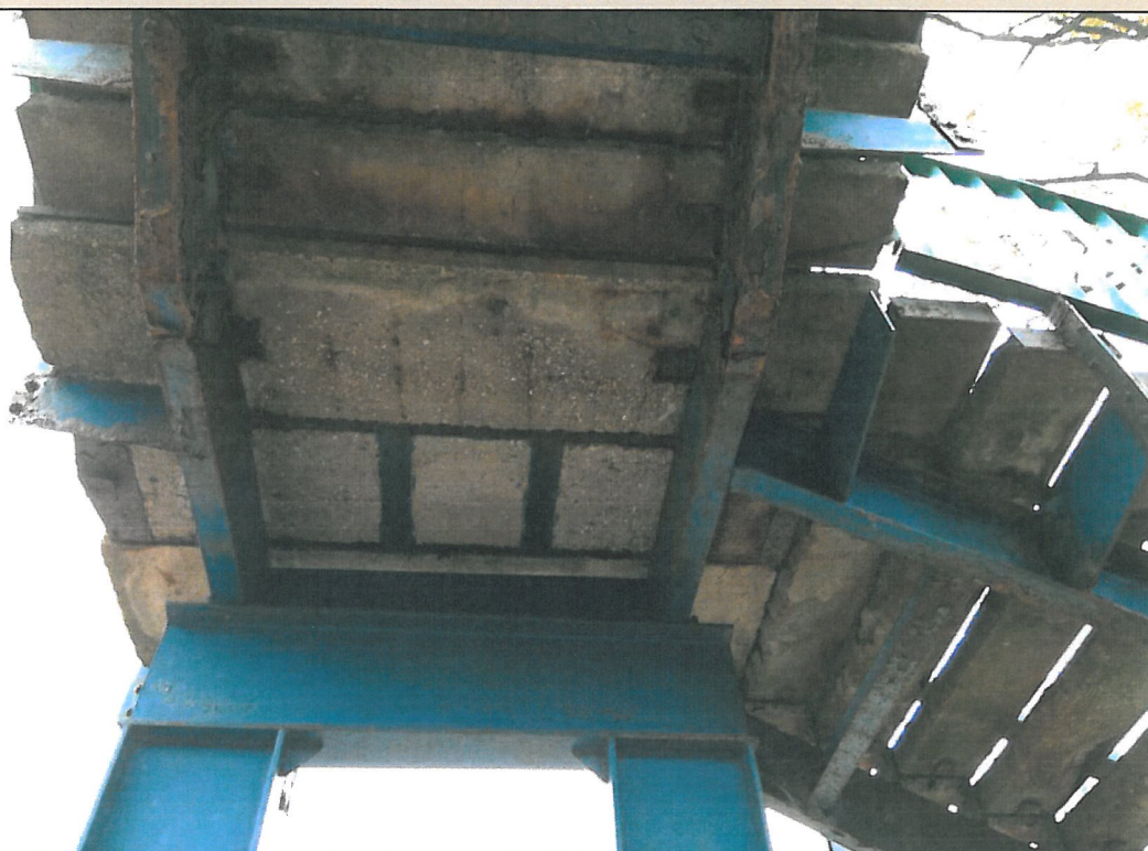
12. Degradacja elementów betonowych, korozja konstrukcji stalowej
