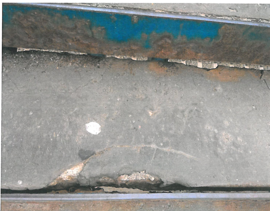
28. Ubytki betonu i asfaltu
