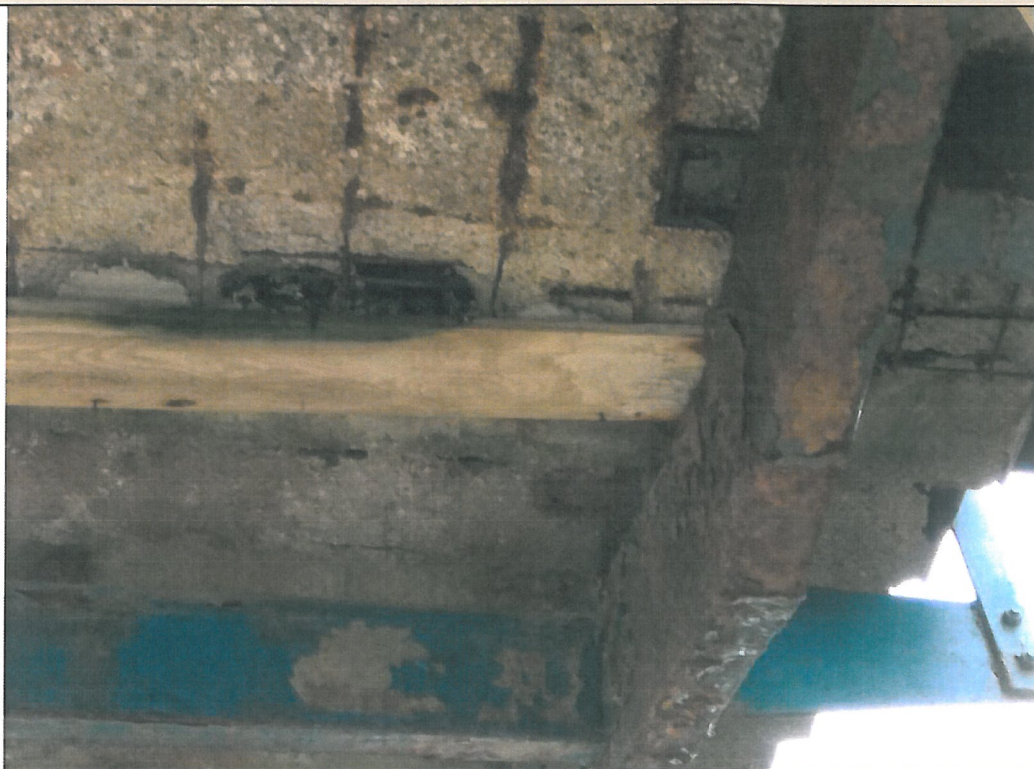
40. Ubytki betonu. Korozja elementów
