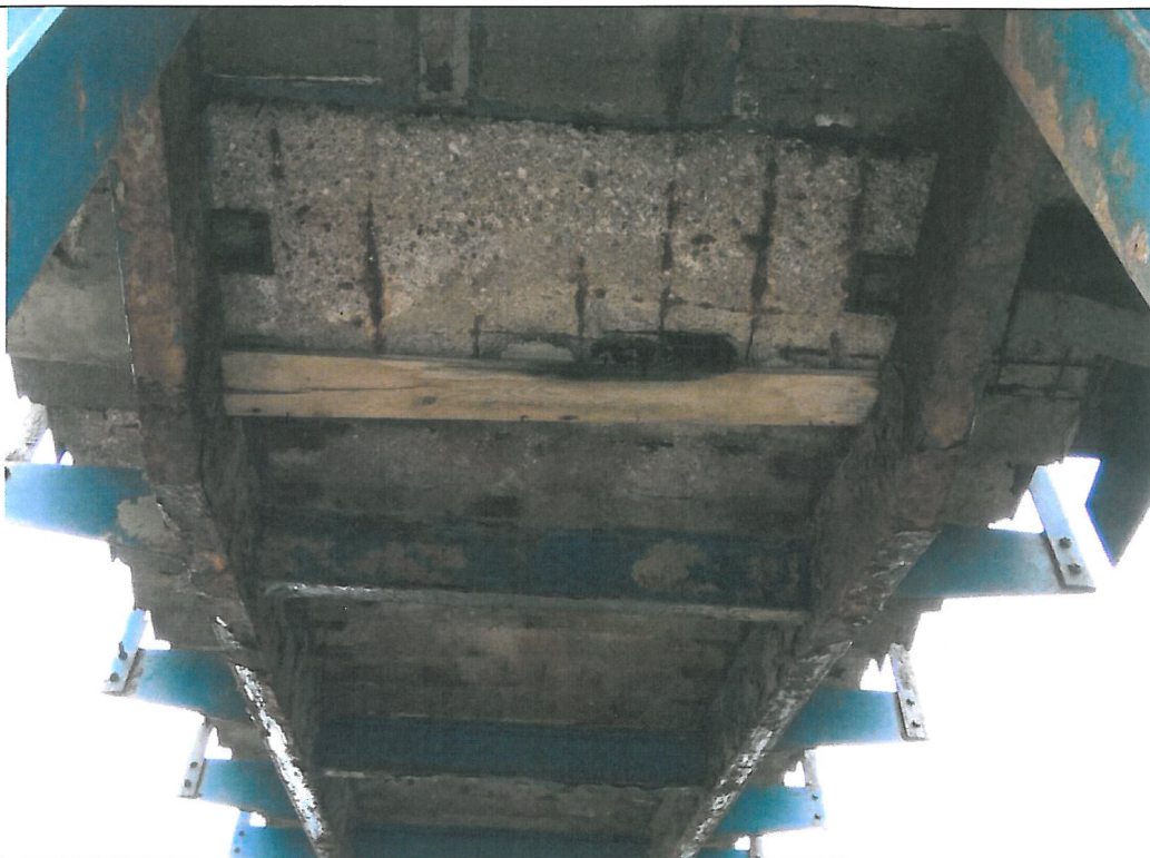
39. Ubytki betonu. Korozja elementów
