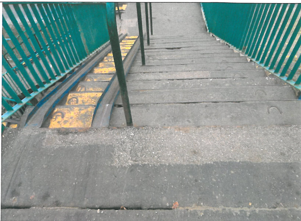
27. Ubytki betonu i asfaltu
