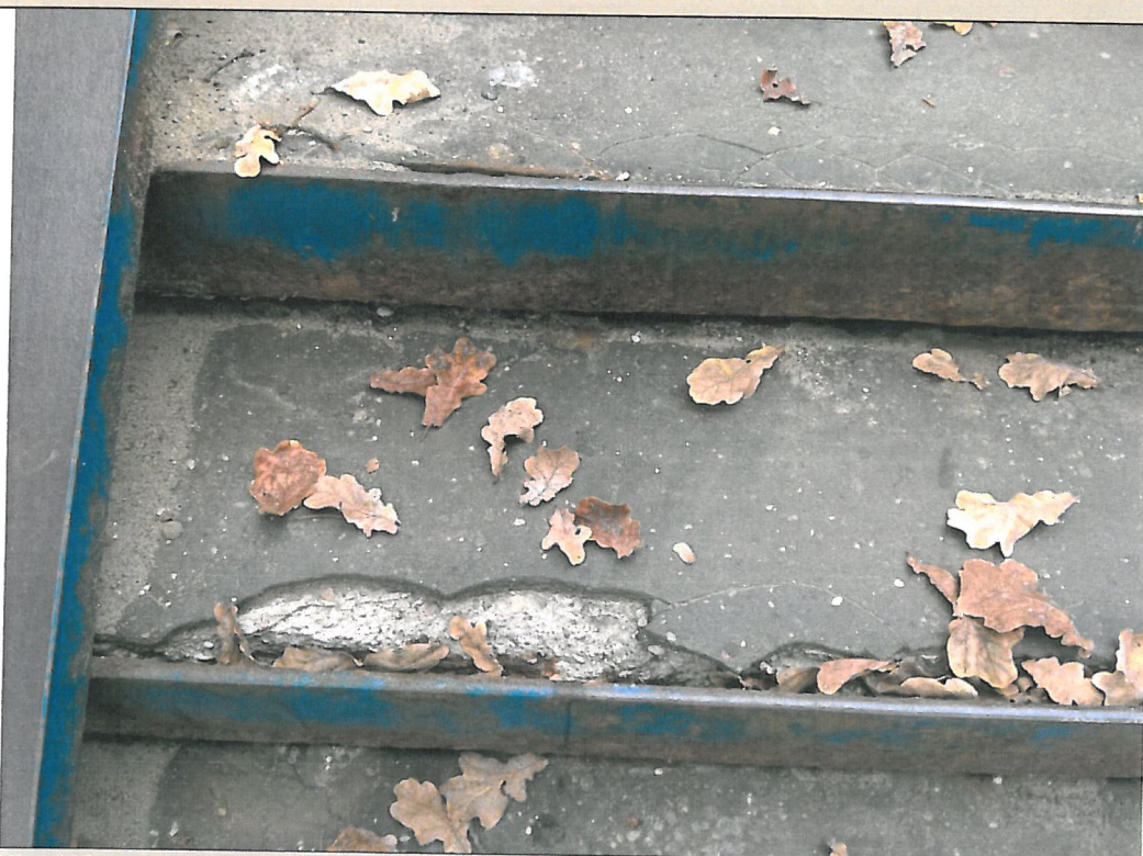
6. Ubytki betonu i asfaltu Korozja elementów
