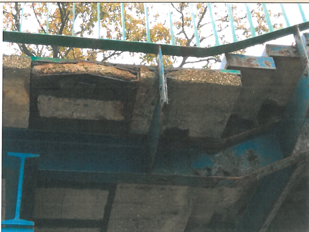
2. Degradacja elementów betonowych
