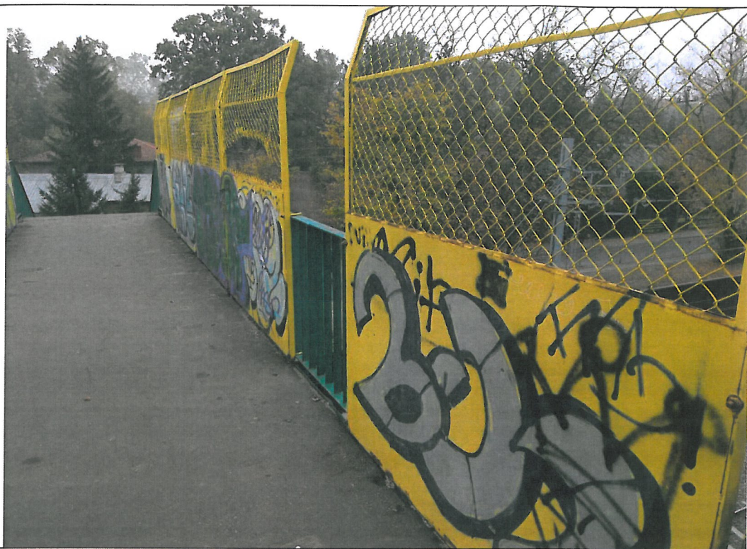
23. Przerwa w zabezpieczeniu balustrady na środku kładki
