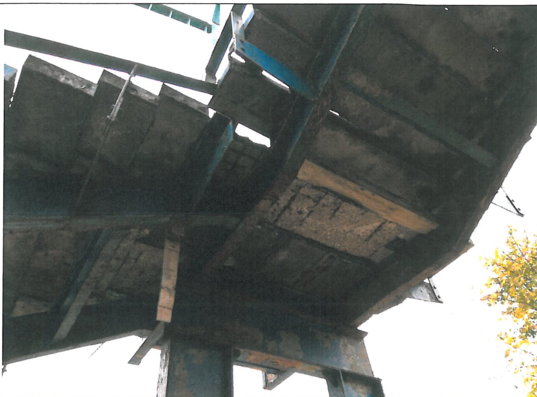
37. Ubytki betonu. Korozja elementów
