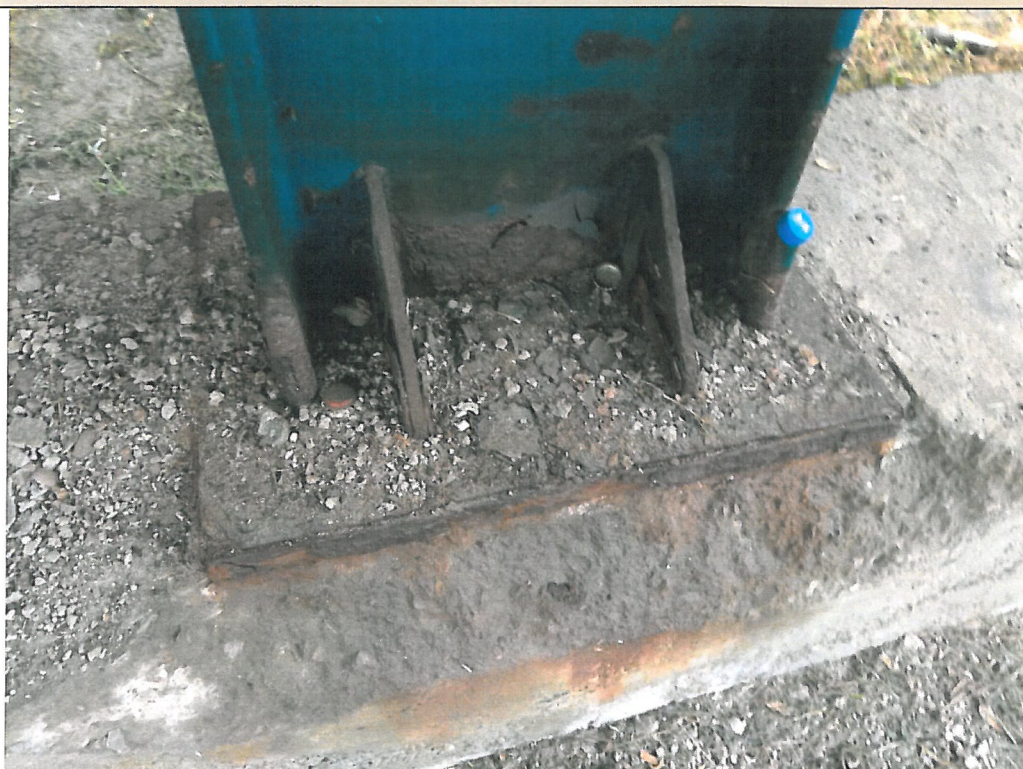
42. Ubytki betonu. Korozja elementów
