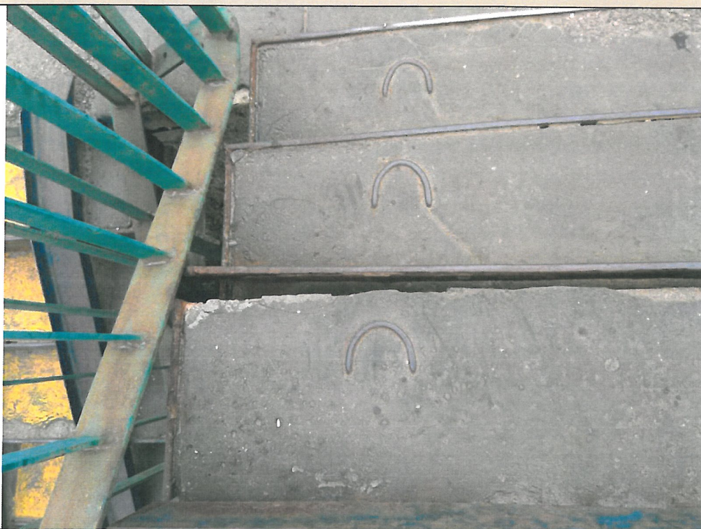
32. Korozja spawów elementów stalowych
