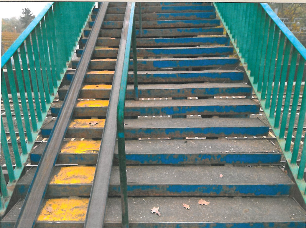
18. Ubytki betonu i asfaltu Korozja elementów
