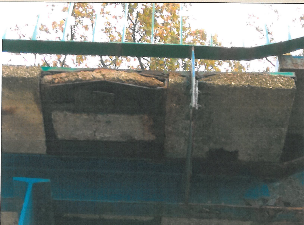
14. Ubytki betonu. Korozja elementów
