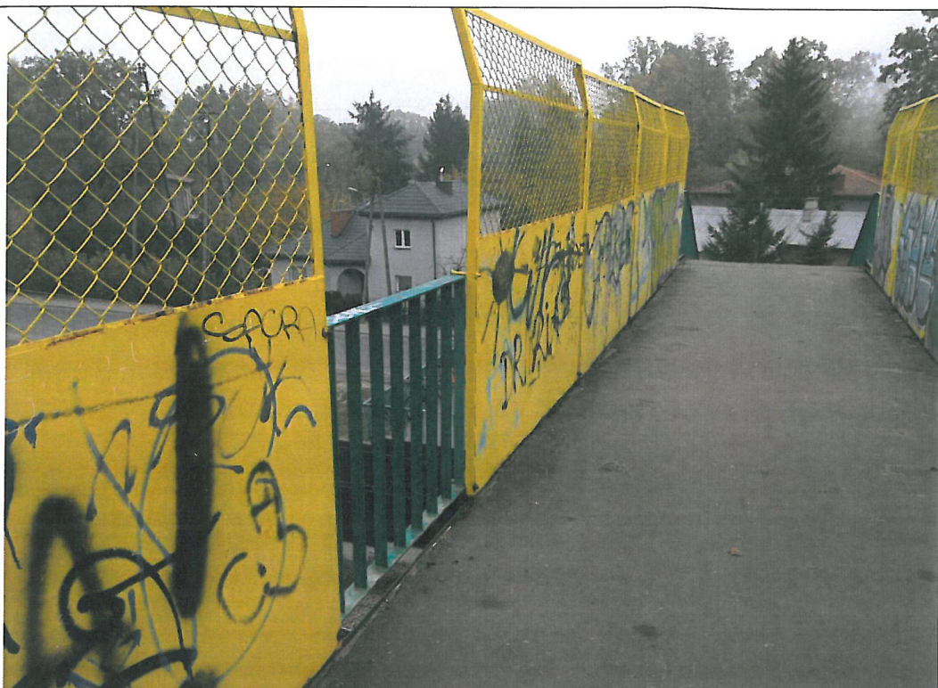
25. Przerwa w zabezpieczeniu balustrady na środku kładki
