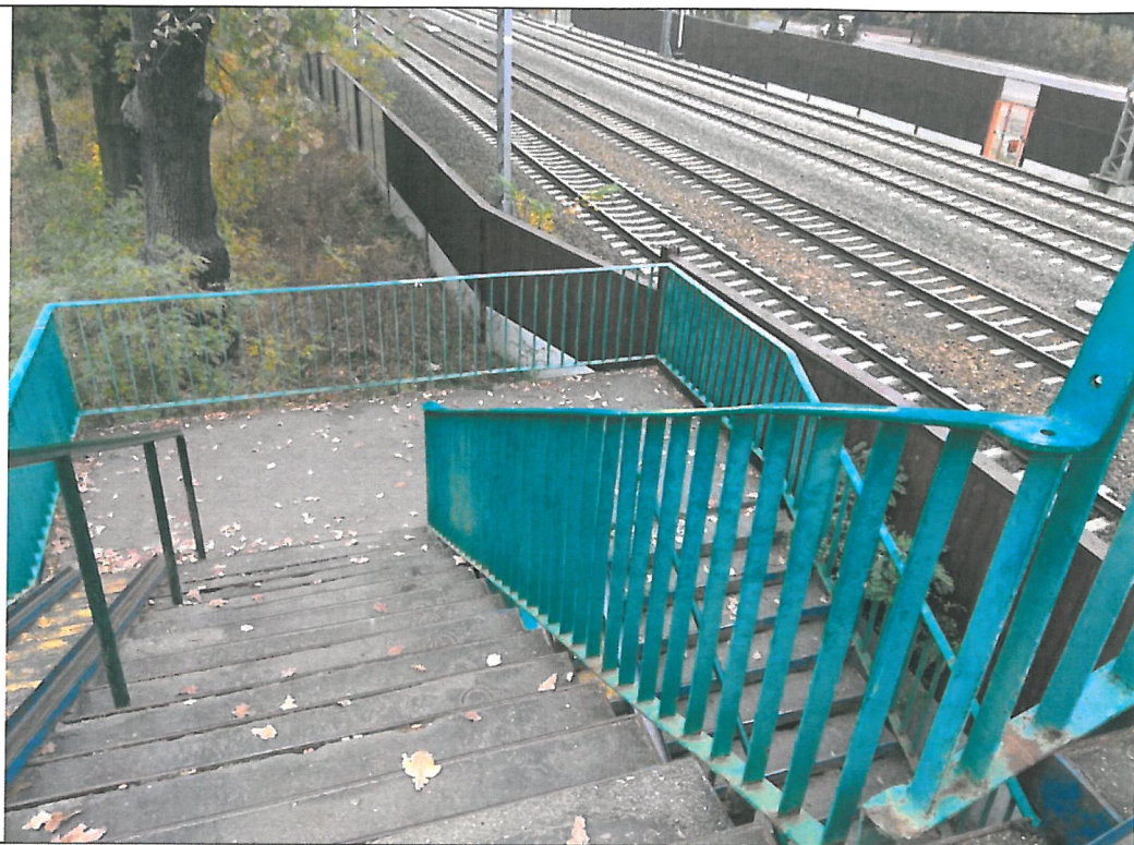
21. Ubytki betonu i asfaltu Korozja elementów
